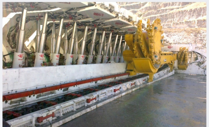
Komplet širokočelnog sistema isporučen u rudnik Ömerler, Turska, integracija kineskih i europskih marki. Isporučen na temelju "ključ u ruke" uklj. instalaciju stavljanje u pogon & rad.
